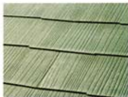
住宅用化粧スレート屋根の変退色
