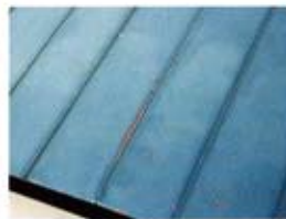
トタン屋根の変退色
